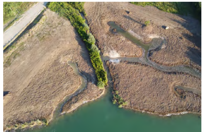
▲ Photos des travaux en cours, création des noues et des berges en pente douce
